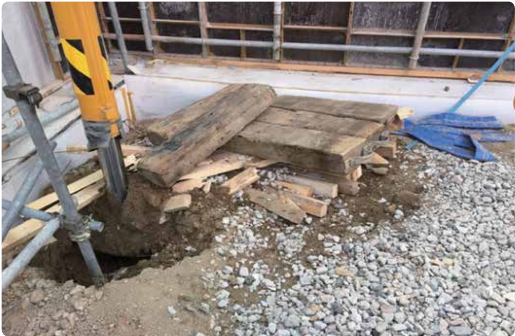
[사진 1] 재해 직후 아우트리거 상태
