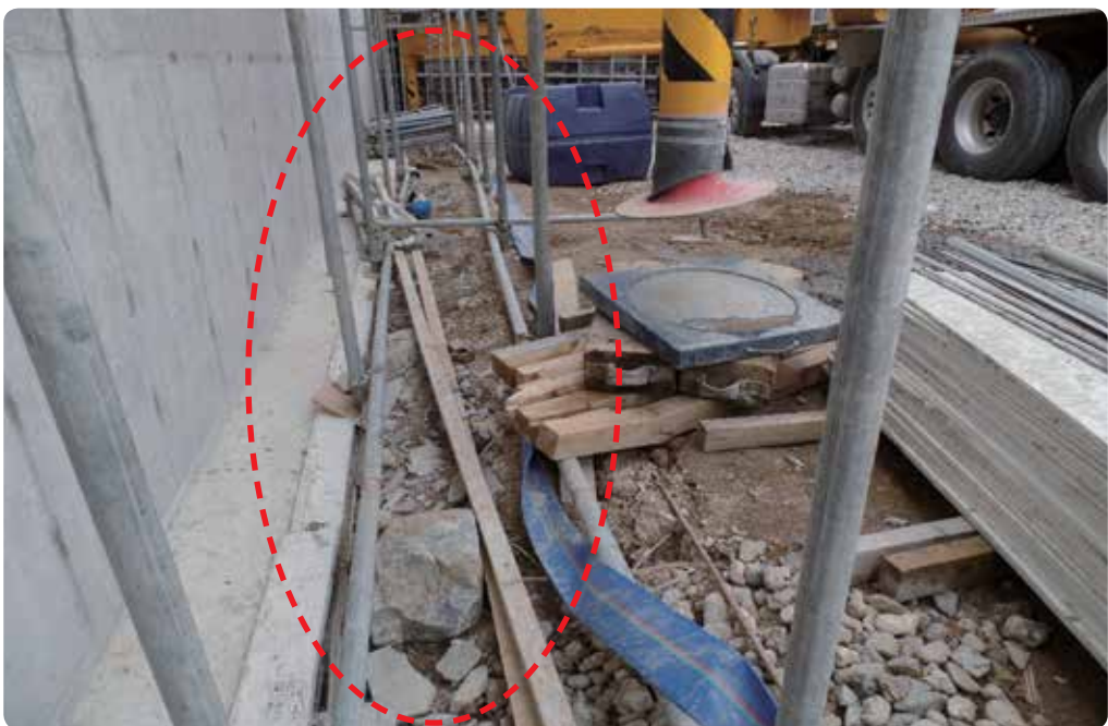
[사진 2] 펌프카 아우트리거가 설치된 되메움 지반
