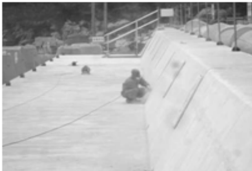
그라인딩작업시 비산먼지 억제조치 미이행
