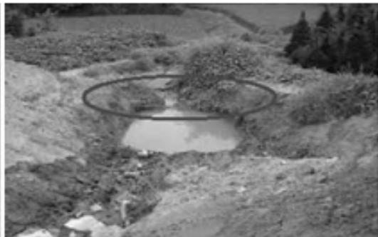
침사지 미설치로 흙탕물 배출
