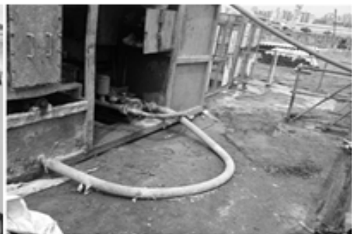
물탈믹서기 물탈여액 누출
